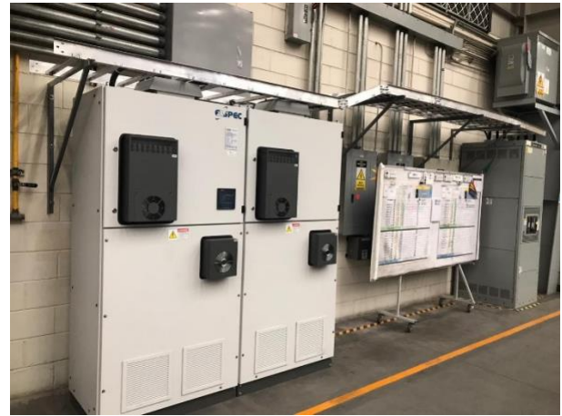
Figura 1.2 Imagen del equipo instalado
